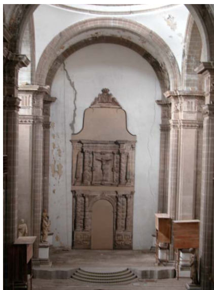
Grietas en muros y columnas.
